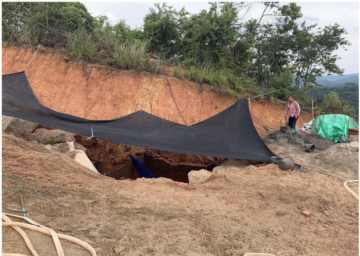
矿山道路区砖砌沉沙池
