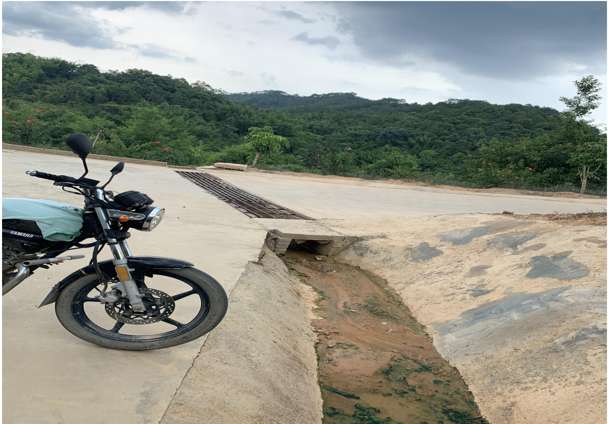
矿山道路区排水设施
